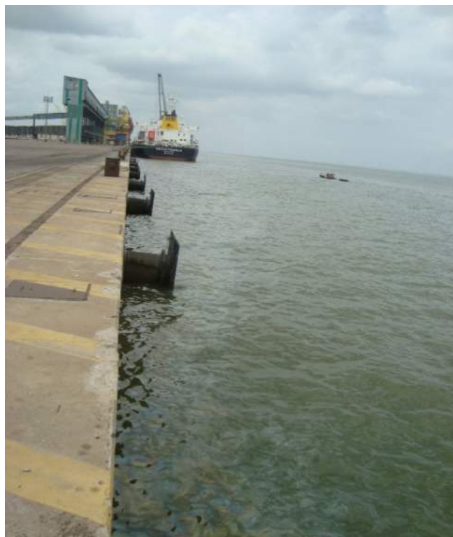
Figura 4: presença de óleo no rio no lado do píer oposto ao do acidente.
